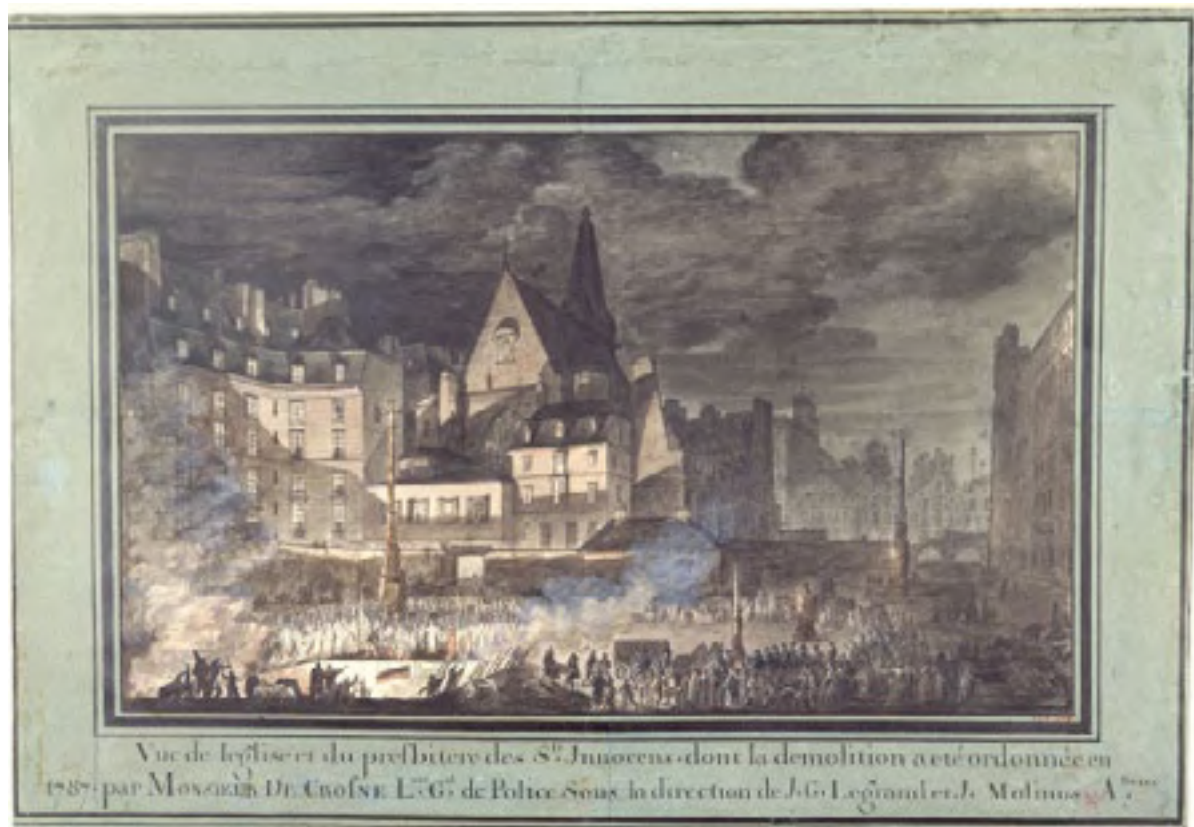
Vue de l'église et du presbytère des Saints Innocents, dont la démolition a été ordonnée en 1787. Dessin de Sobre. Paris, musée Carnavalet © Musée Carnavalet / Roger-Viollet
